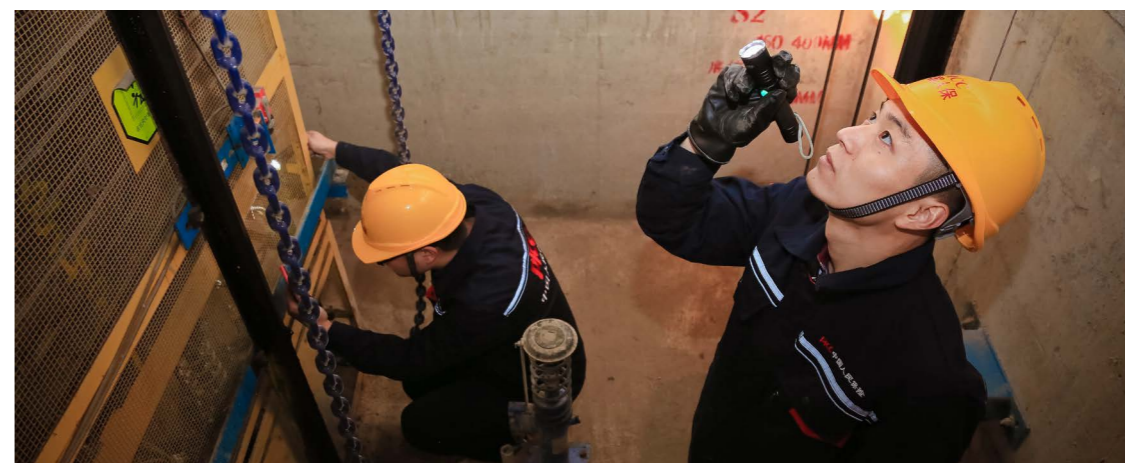
工作人员定期对电梯进行全面“体检”和监测
