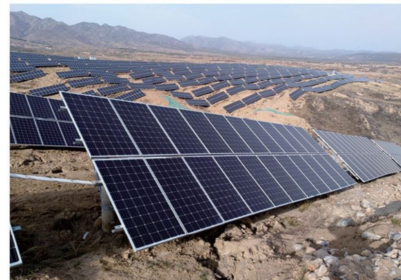
公司承保的山西省太原市阳曲县、忻州市代县光伏扶贫电站
